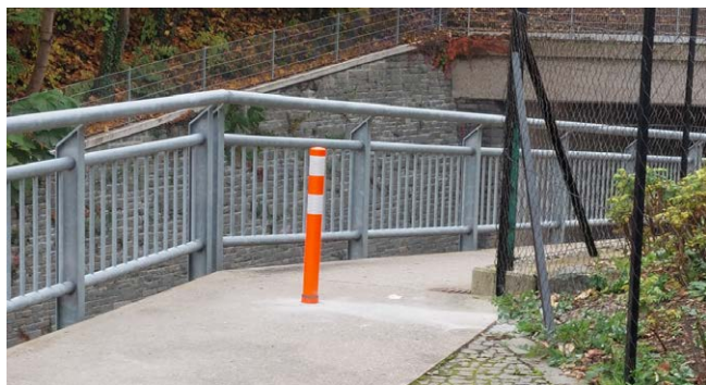
Gefahrenbereich Fussgängerbrücke Schloss Persenbeug
